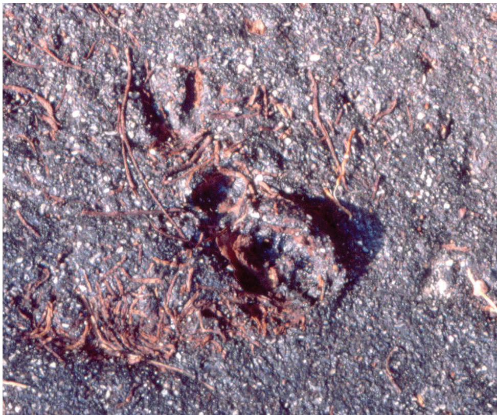
Abb. 6: Oberfläche der Bahn mit Wurzeleindringungen (Detail)
