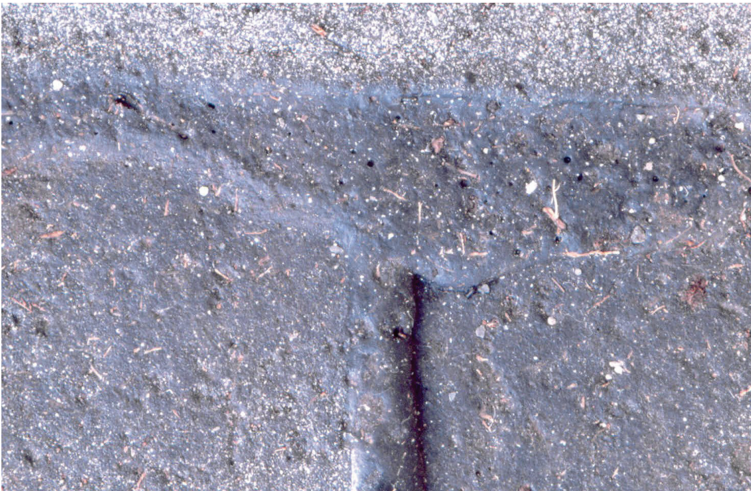
Abb. 2: Oberfläche der Bahn im T-Stoß-Bereich
